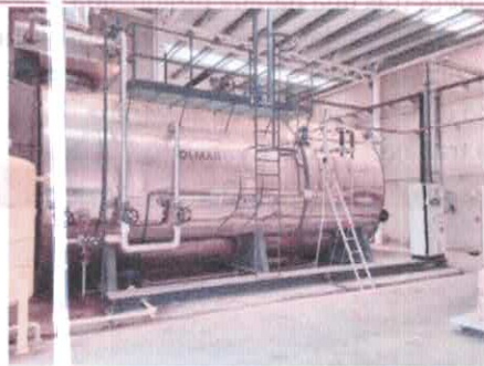
Interior de la sala de calderas
