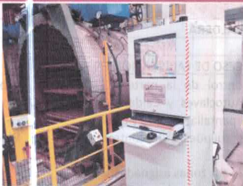
Puesto de control
