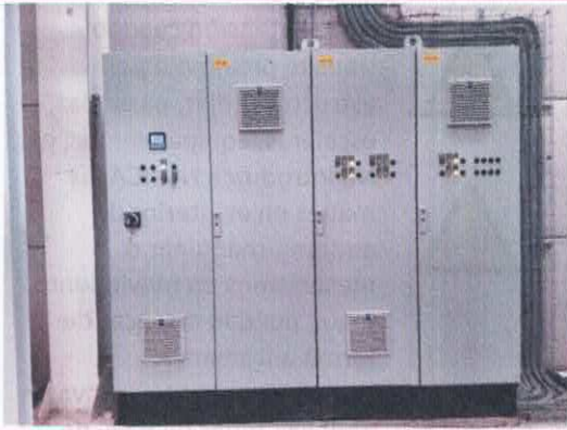
Armario eléctrico zona tanques de lechada
