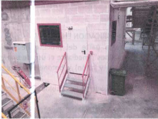
Cabina de control
