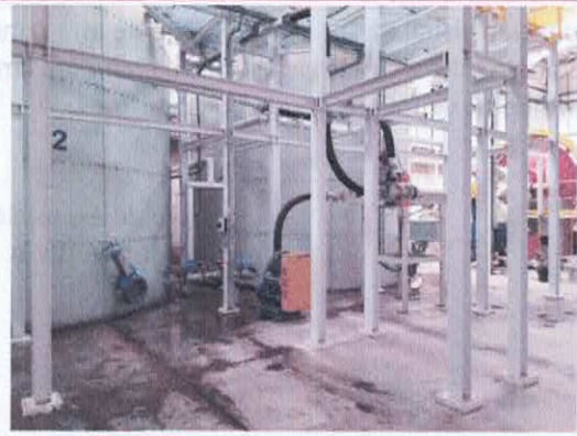
Zona tanques de lechada
