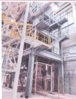
Zona de torre de mezclado
