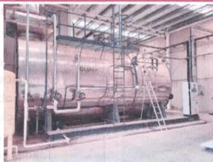
Sala de calderas
